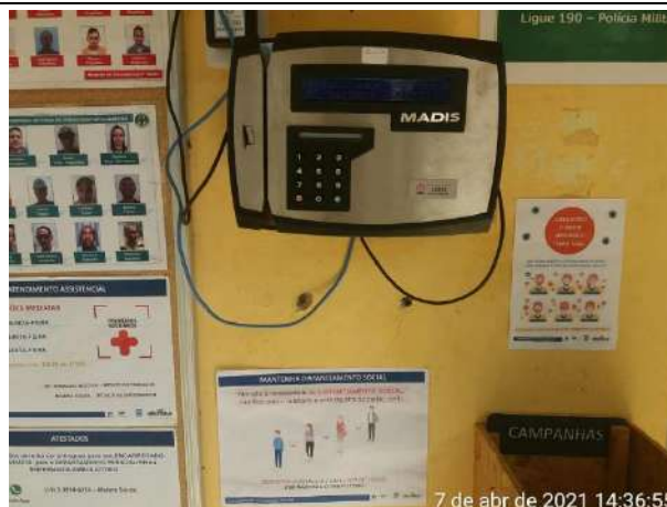
Foto 4 – Material educacional sobre Ações em Combate e Prevenção à COVID-19, mantenha o distanciamento, relógio ponto Canteiro Administrativo. Data: (07/04/2021)
