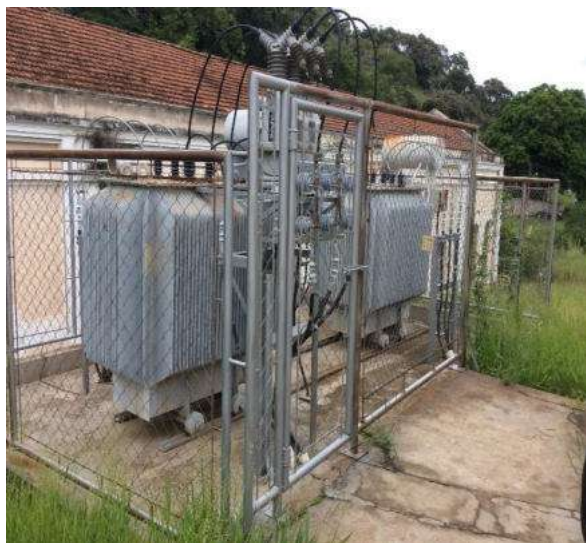
Figura 11.5-14: Transformadores instalados na AS01.
