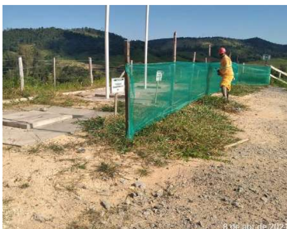
Foto 7 – Organização e limpeza em torno de tanque anaeróbico no canteiro Industrial. Data: (08/04/2021)
