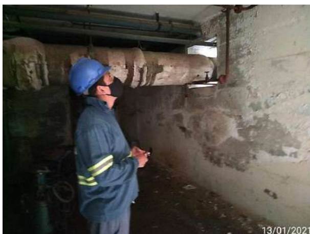
Foto 7 – Avaliação dos edifícios, antes do início das atividades, em porão da termoelétrica. (Data: 13/01/2021).
