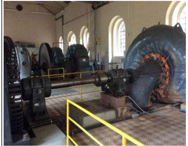
Figura 11.5-11: Motores de geração ativos.
