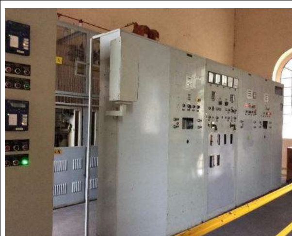
Figura 11.5-13: Painel de controle.
