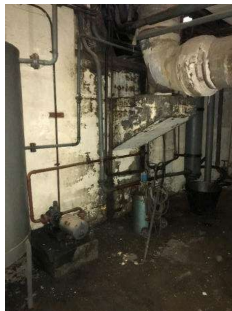
Figura 11.5-9: Encanamentos aéreos utilizados para conduzir o óleo para filtragem, na parte inferior do local.
