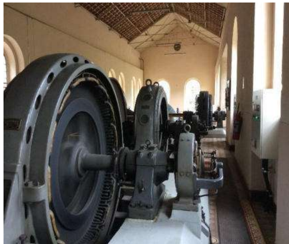
Figura 11.5-10: Motores de geração ativos.
