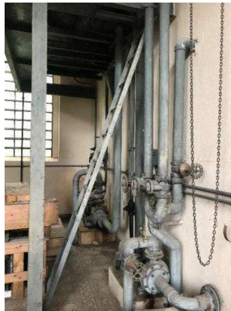
Figura 11.5-7: Encanamento aéreo utilizado para abastecimento da unidade geradora.
